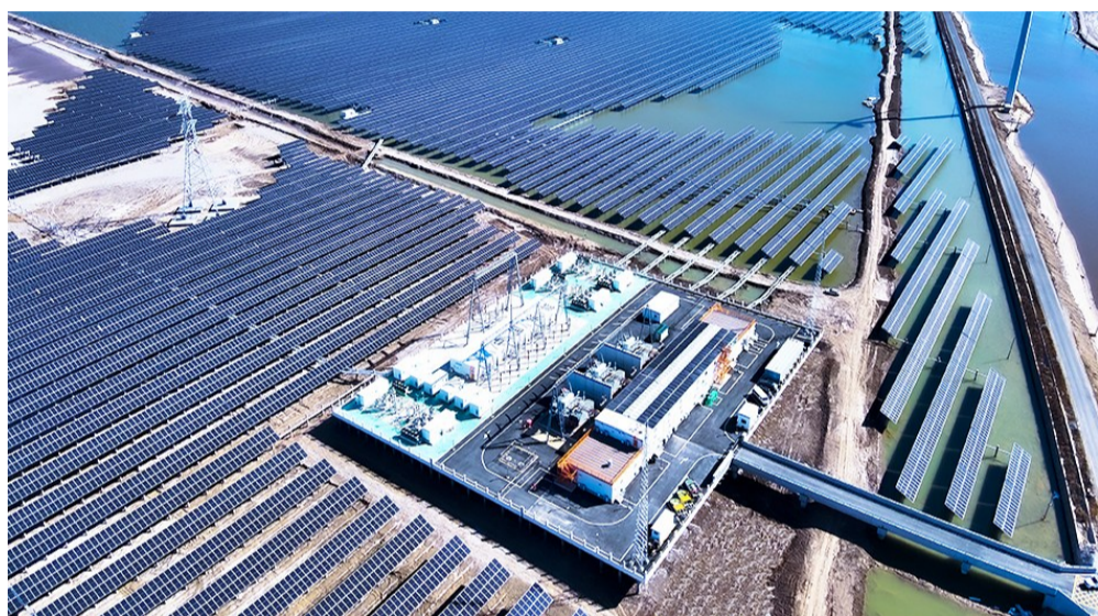
华能沾化新能源有限公司华能滨州新能源85万千瓦光伏发电项目,项目总投资43.5亿元,项目列入国家第三批风电光伏大型基地,年发电量可达11.3亿千瓦时
