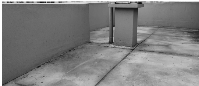
4月15日拍的王先生家尚未维修的楼顶
